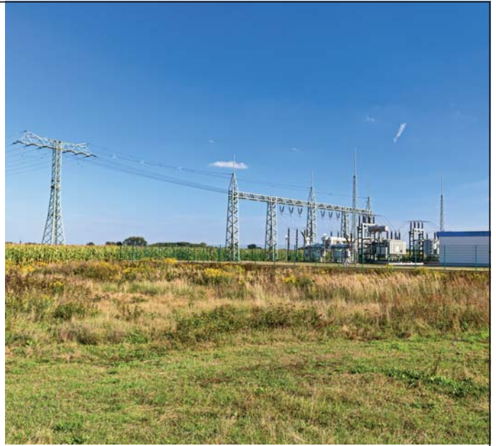
Umspannwerk Neustadt-Glewe Neustadt-Glewe substation
