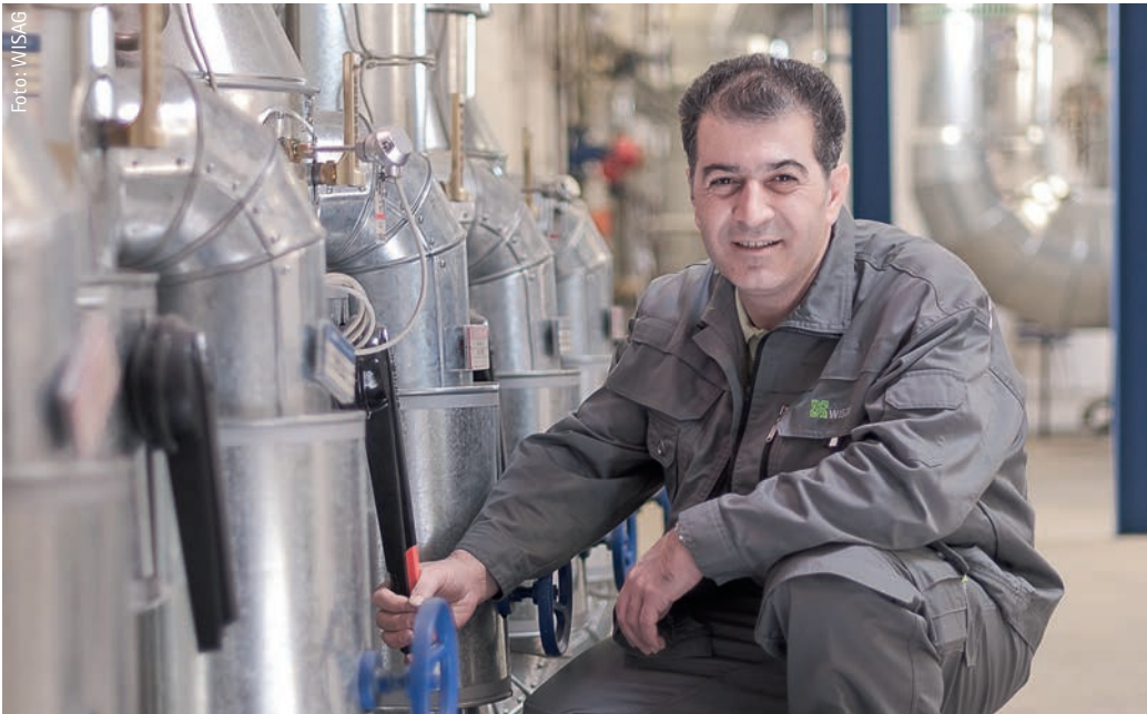
WISAG Servicemonteur bei der Inspektion und Wartung eines Heizkreisverteilers
