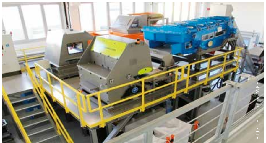
Smarte, modular aufgebaute Multisensor-Sortieranlage, mit der KI-gestützte Trenn- und Sortierkonzepte entwickelt, erprobt und validiert werden.
