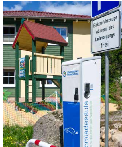
Der Strom wird aus eigenen Photovoltaikanlagen und Blockheizkraftwerken selbst produziert.
