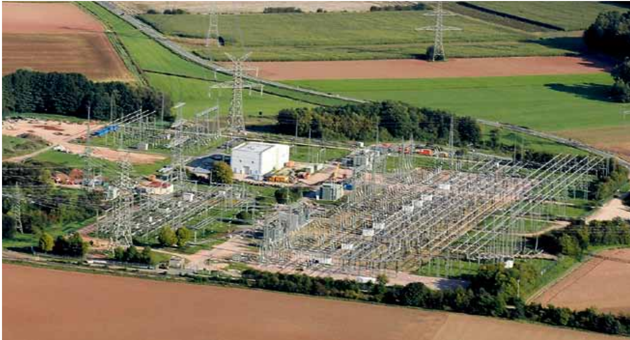
Das Umspannwerk Etzenricht in der Oberpfalz. Foto: Alois Köppl
