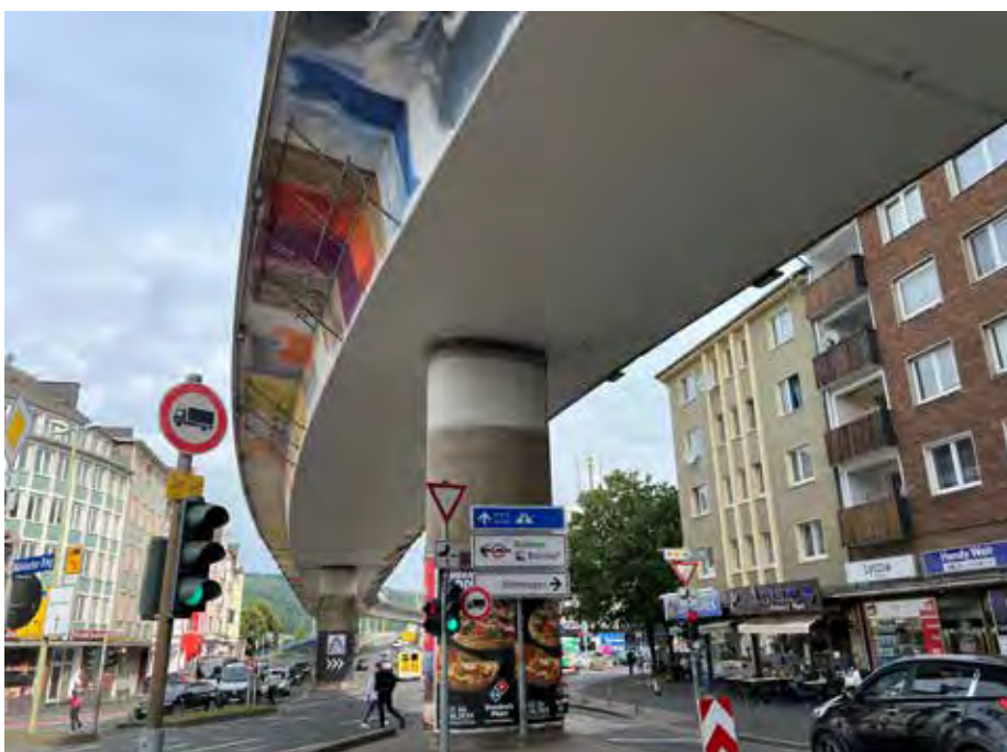
Die Ebene II in Hagen (Brücke oben) ist komplett für den Verkehr gesperrt.
