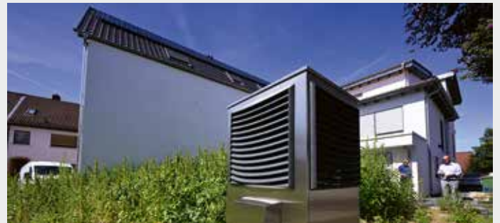
Vor einem neu gebauten Wohngebäude ist im Garten eine Wärmepumpe zum Heizen des Gebäudes in Betrieb. Foto: Bernd Weißbrod/dpa
