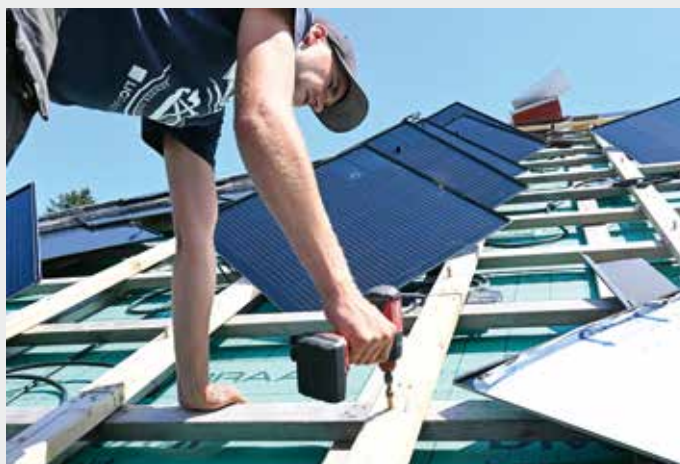
Handwerker arbeiten an einem Photovoltaik-Dach. Die neuartige Anlage besteht aus Modulen in Form von Dachplatten.
