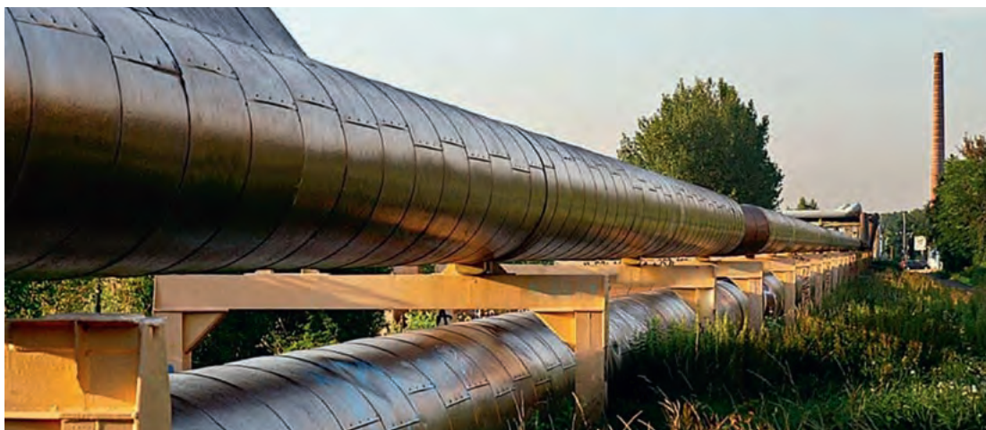
Blick auf die Fernwärmetrasse der EVH: Über ein 217 Kilometer langes hochmodernes Fernwärmenetz erreicht die in den beiden Energieparks Dieselstraße und Trotha erzeugte Fernwärme bequem und sicher jeden Winkel der Saalestadt.
