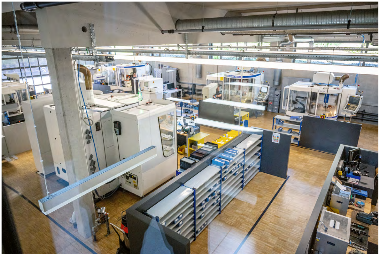
Mithilfe eines Systems zur Wärmerückgewinnung von Maschinen kann das Gebäude gekühlt und geheizt werden – bei deutlich geringerem Energieverbrauch. Fotos: Thomas Neu
