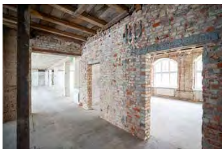
Das freigelegte historische Mauerwerk wird erhalten und in das neue Konzept einfließen.
