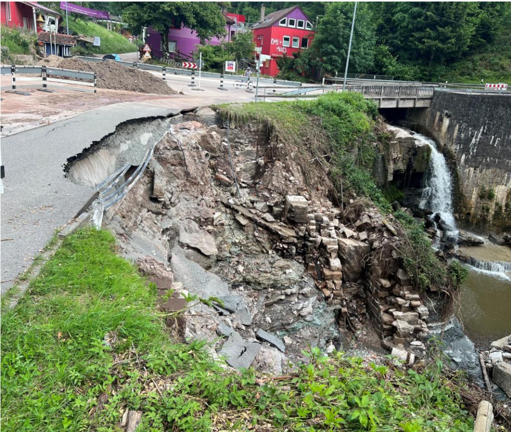
Hangrutschung bei der Laufenmühle
