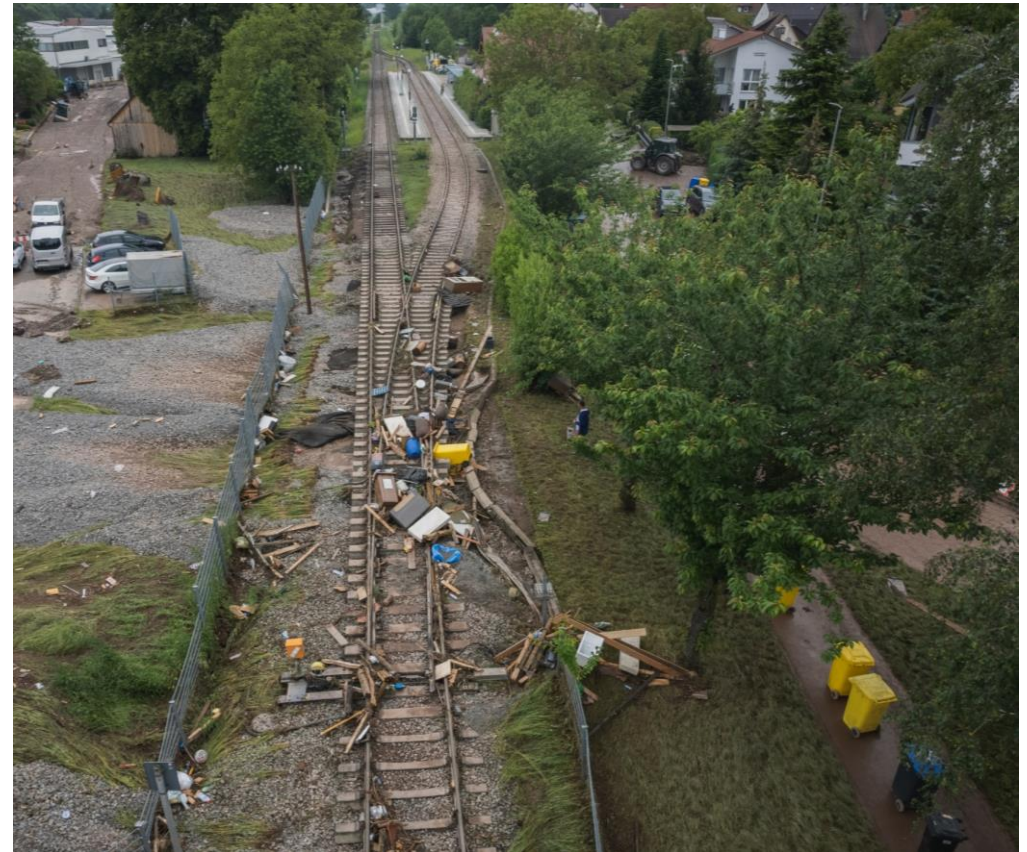
Massive Schäden an den Gleisen der Wieslaufalbahn
