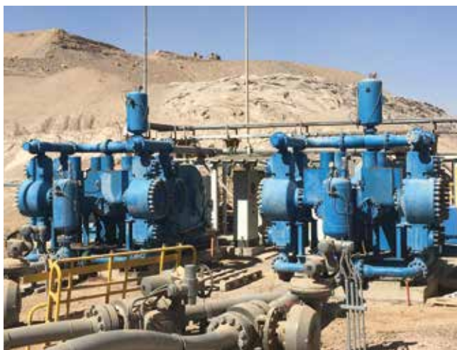
Einsatz der ABEL-Pumpen in einer südamerikanischen Mine
