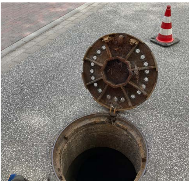
Abbildung 4: Schachtdeckel (Quelle: Hamburger Stadtentwässerung AÖR)
