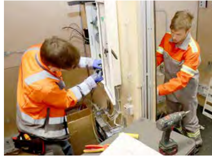
Drei Tage lang tüftelten die Teilnehmer am nationalen Endausscheid über einer komplexen Elektro-Anlage.
