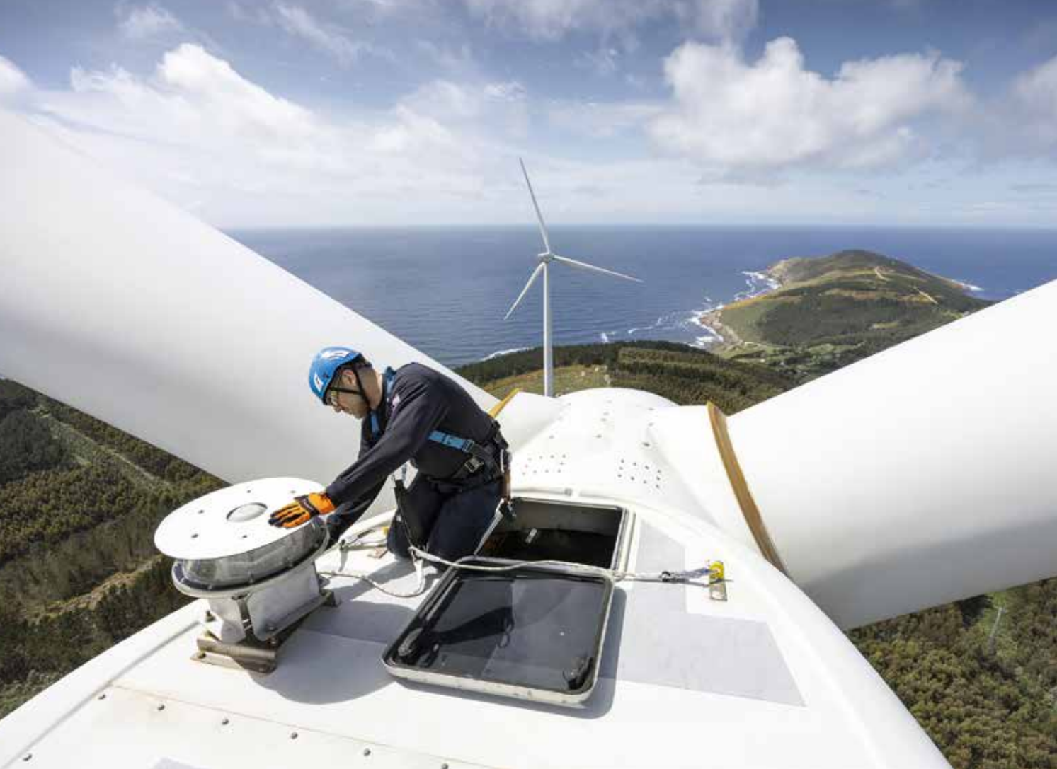
Der Arbeitsplatz eines Mechatronikers: die Gondel einer Windkraftanlage
