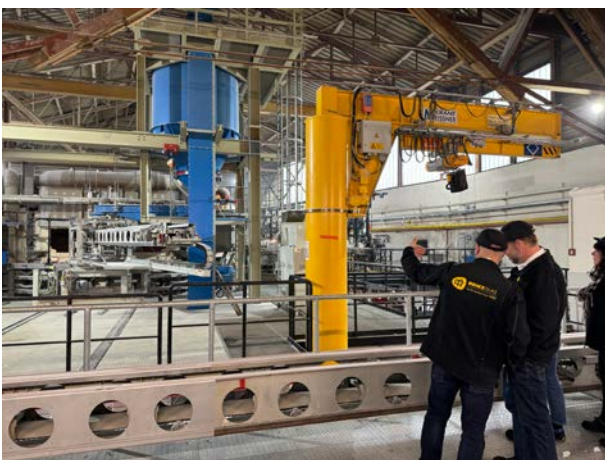
Blick auf einen Teil der neuen Elektroglasschmelzwanne in Kleintettau.
