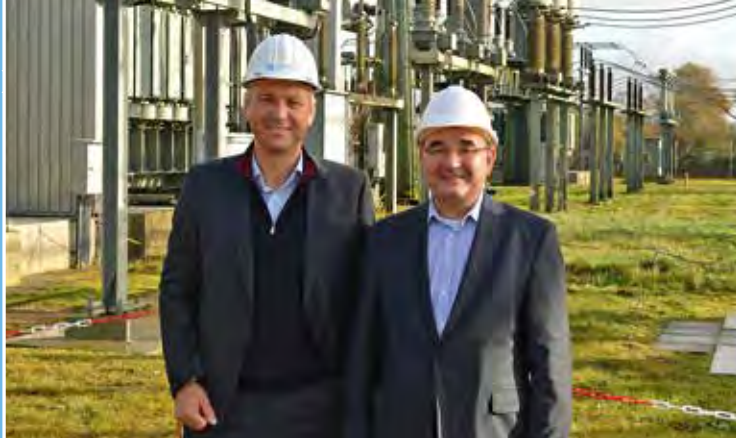
Matthias Boxberger (links), Vorstand von SH Netz, und Dr. Martin Grundmann, Geschäftsführer von Arge Netz, im Umspannwerk Schobüll
