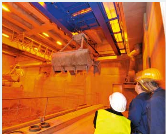
Neuer Schlackekran der MVK
