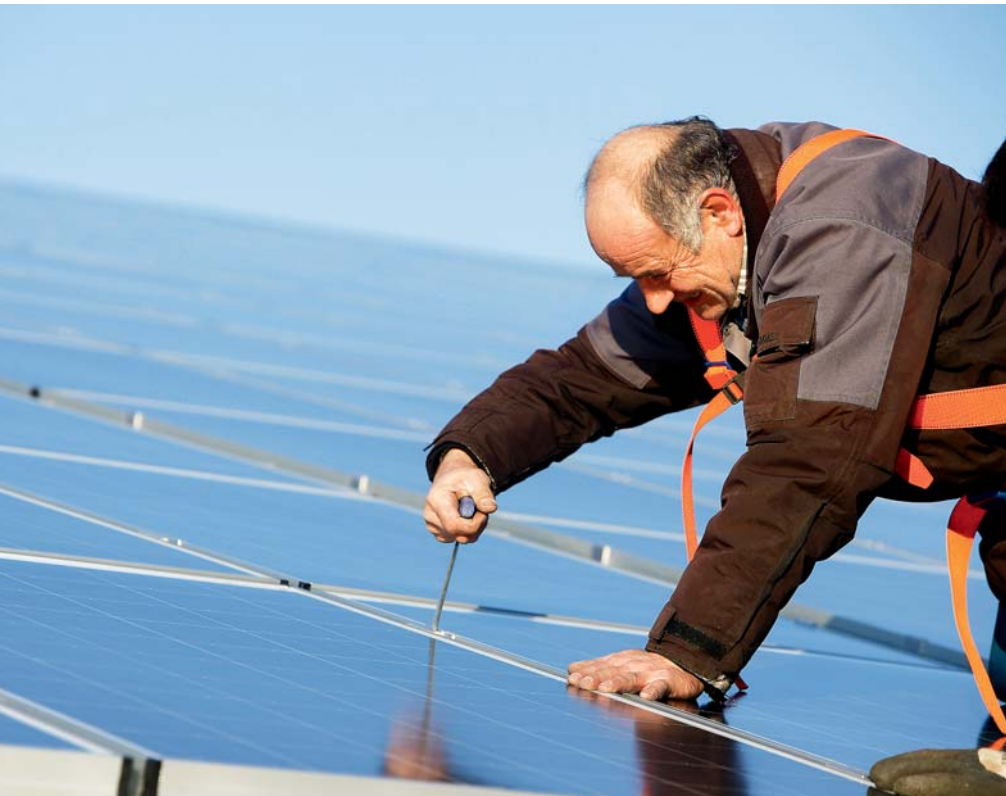
Eine 200 Kilowatt-Peak Solarstromanlage hat die Firma EWS auf dem Dach der Lagerhalle installiert.
