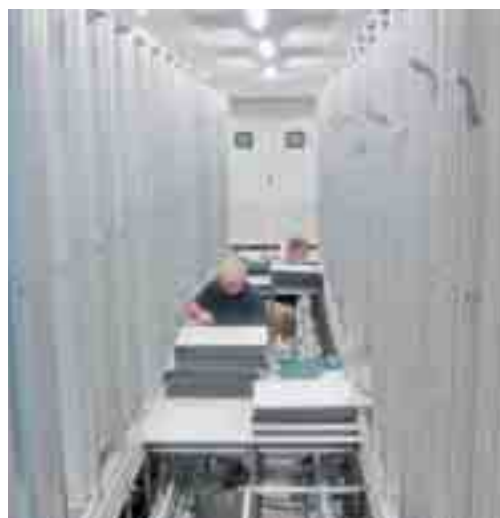
Ob Büro-, Industrie- oder Serveranlagen: Präventiv- wartung kann vor größeren Ausfällen schützen.
